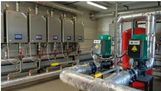
Рис. 2. Энергоэффективная газовая котельная с котлами NAVIEN
