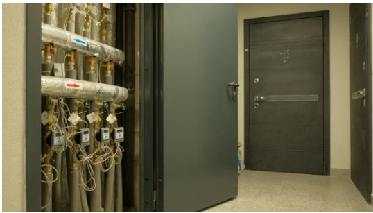
Рис. 3. Гребенка распределительного пункта с приборами учета тепла
