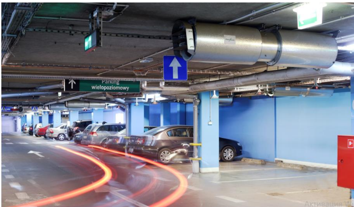
Рис. 1. Подземная автостоянка, оснащенная струйными вентиляторами
