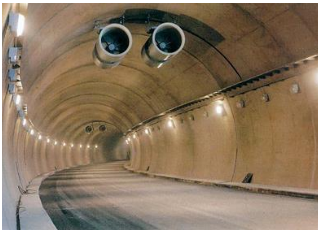
Рис. 2. Автодорожный тоннель, оснащенный струйными вентиляторами
