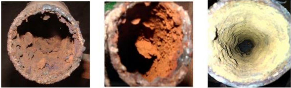
Рис. 5. Состояние сетей ГВС транспортного комплекса. Накипно-коррозионные отложения на поверхностях, контактирующих с водой, толщиной 5–6 мм
