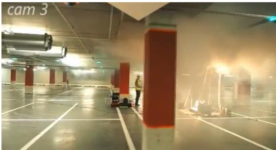
Рис. 8. Испытания противодымной вентиляции в режиме контроля распространения дыма и тепла
