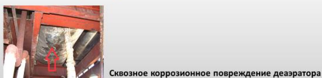
Рис. 2. Состояние теплоэнергетического оборудования при несоблюдении нормативных параметров ВХР
