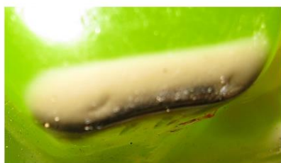
Рис. 10. Биообрастание металлопластовых трубопроводов в системе теплого пола
