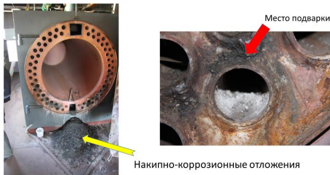
Рис. 20. Состояние внутренней поверхности парового котла в случае недостаточной водоподготовки
