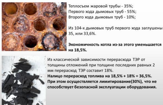
Рис. 3. Влияние несоблюдения параметров ВХР на энергоэффективность работы теплоэнергетических систем
