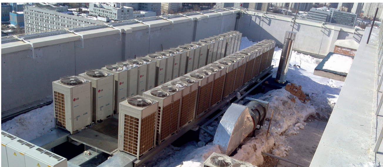
Расположение наружных блоков на кровле
