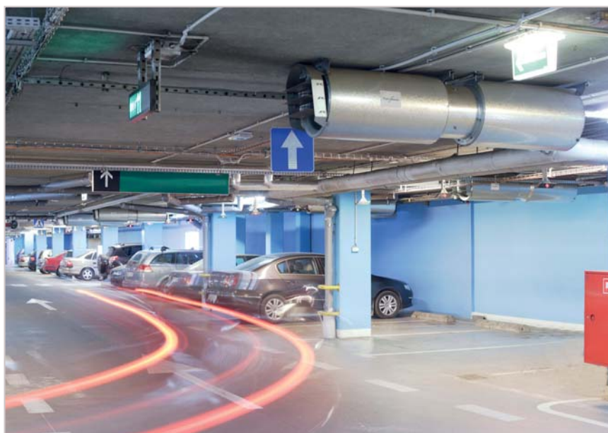
Крытая автостоянка оборудована системой струйной вентиляции
