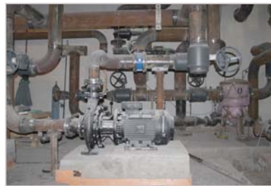
Рис. 4. Насосы GRUNDFOS серии NB в ЦТП, Санкт-Петербург
